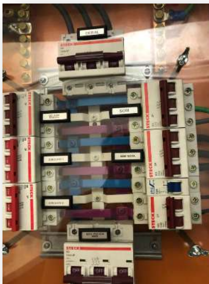
Desativação do Disjuntor Geral
